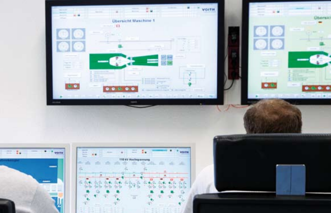
Blick auf die Monitore in der Leitwarte
