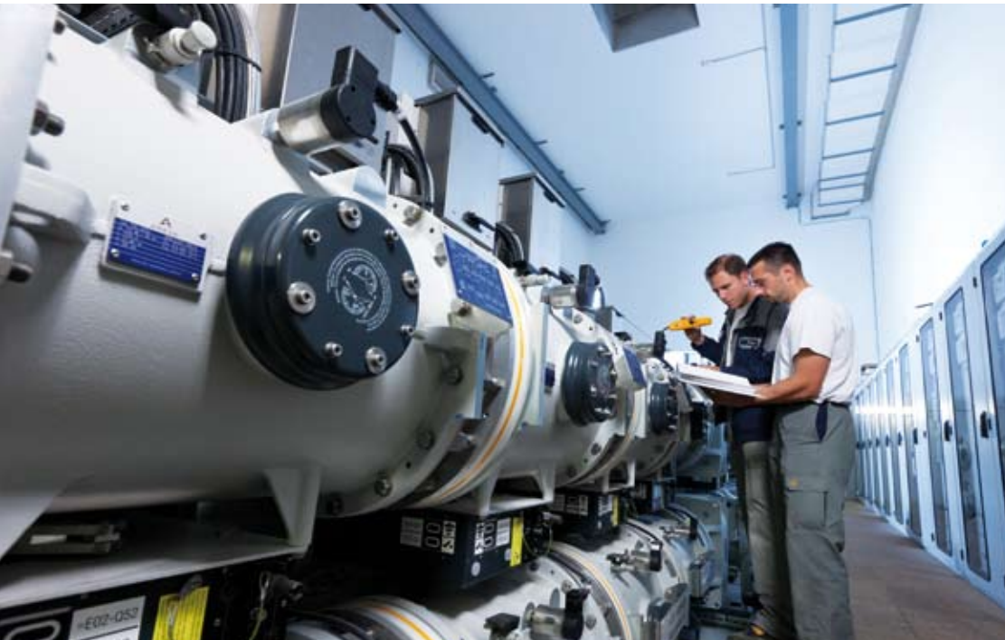
Roman Sahner (links) und Maick Butara überprüfen die gasisolierte 110 kV-Schaltanlage.
