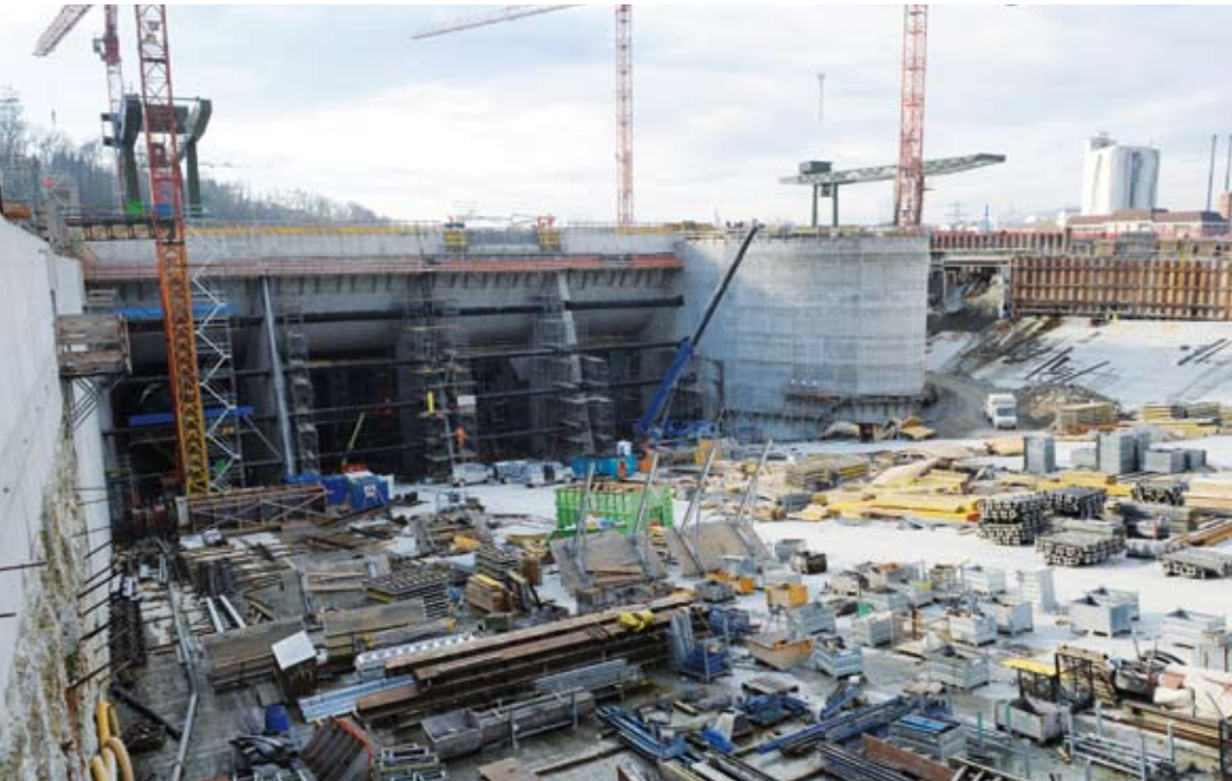
Einlaufplatte und Turbinenkammern, Dezember 2009
